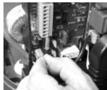
Scollegamento cavi motore da KS
