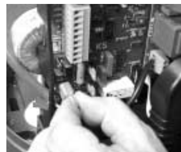
Entfernung der Motorkabel von dem KS
